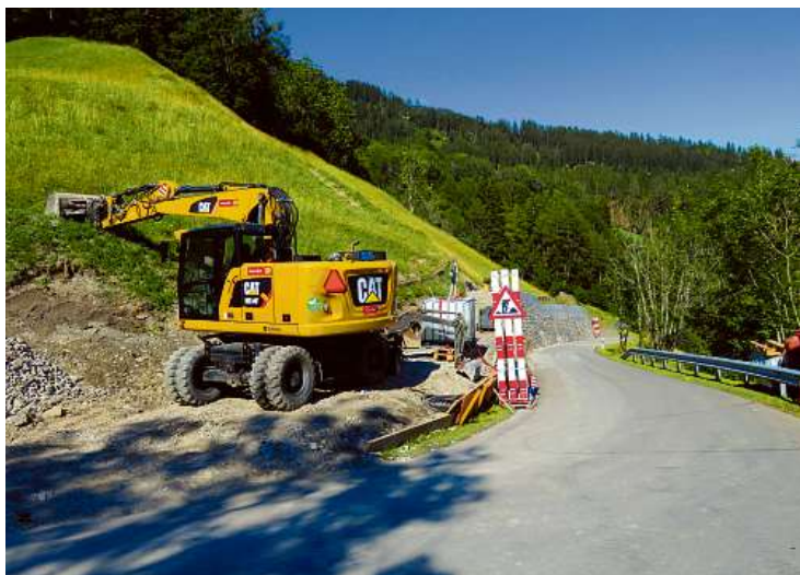
Lüenerstrasse: Am Höhrain erfolgt eine Mauererhöhung, um künftig wiederkehrende Schneerutschungen zu verhindern.
